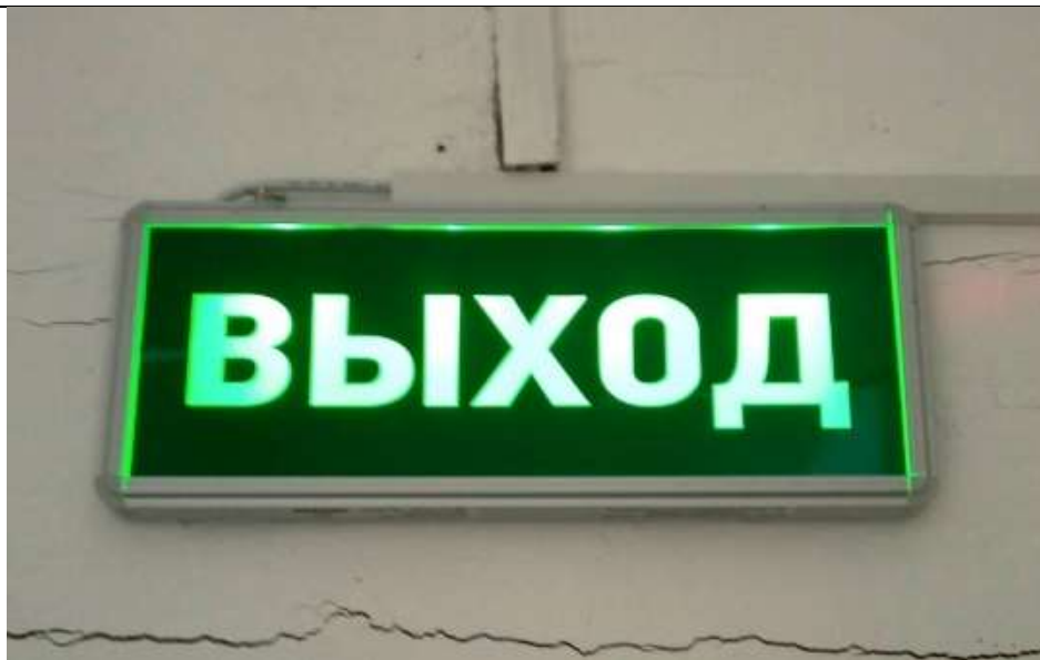
№ 65, Визуальные средства путей эвакуации
